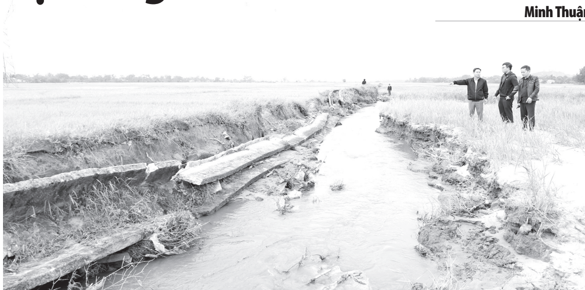
Công ty TNHH MTV Quản lý công trình thủy lợi Đắk Lắk kiểm tra tình hình hư hỏng kênh mương trên địa bàn xã Yang Mao. Ảnh: M. Thuận
