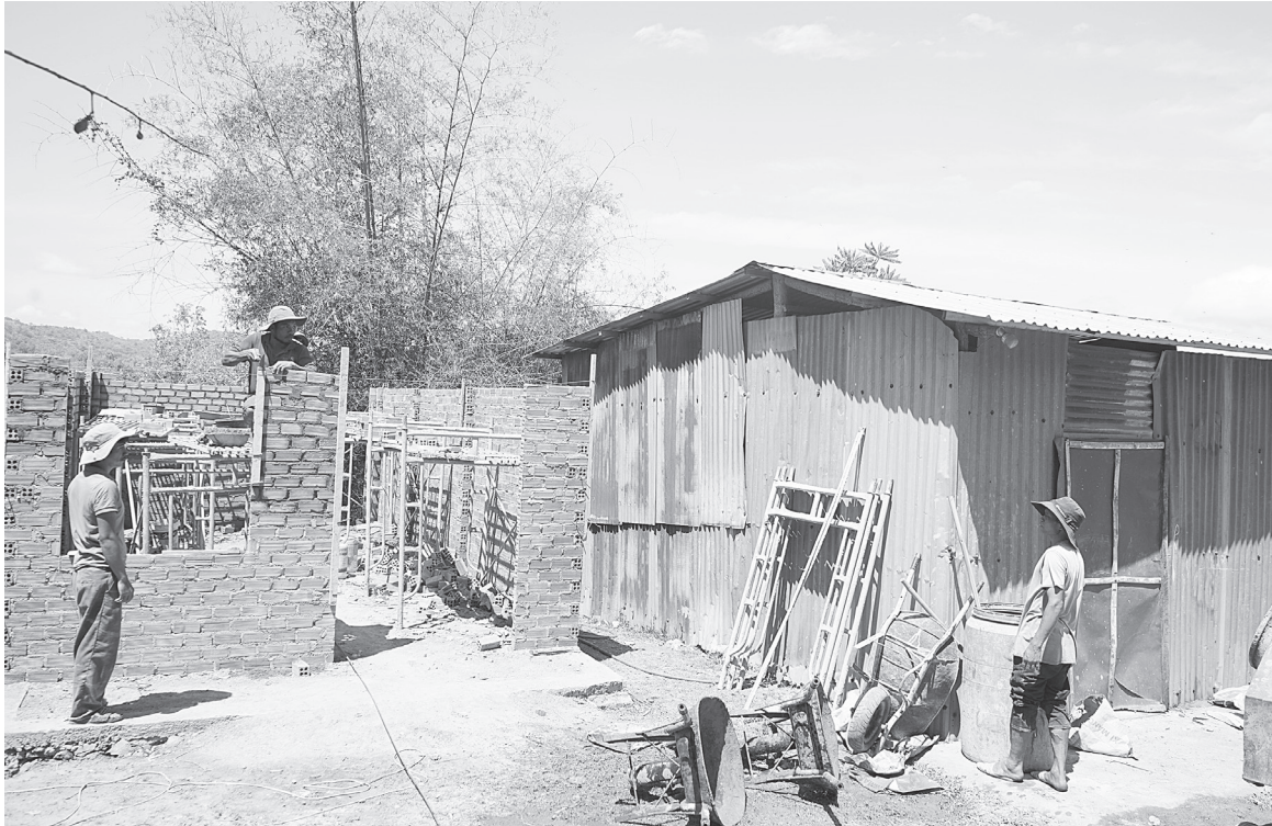
Căn nhà được hỗ trợ xây mới của một hộ nghèo trên địa bàn xã Đắk Liêng (huyện Lắk) bên cạnh căn nhà tôn tạm bợ. Ảnh: T. Hồng
